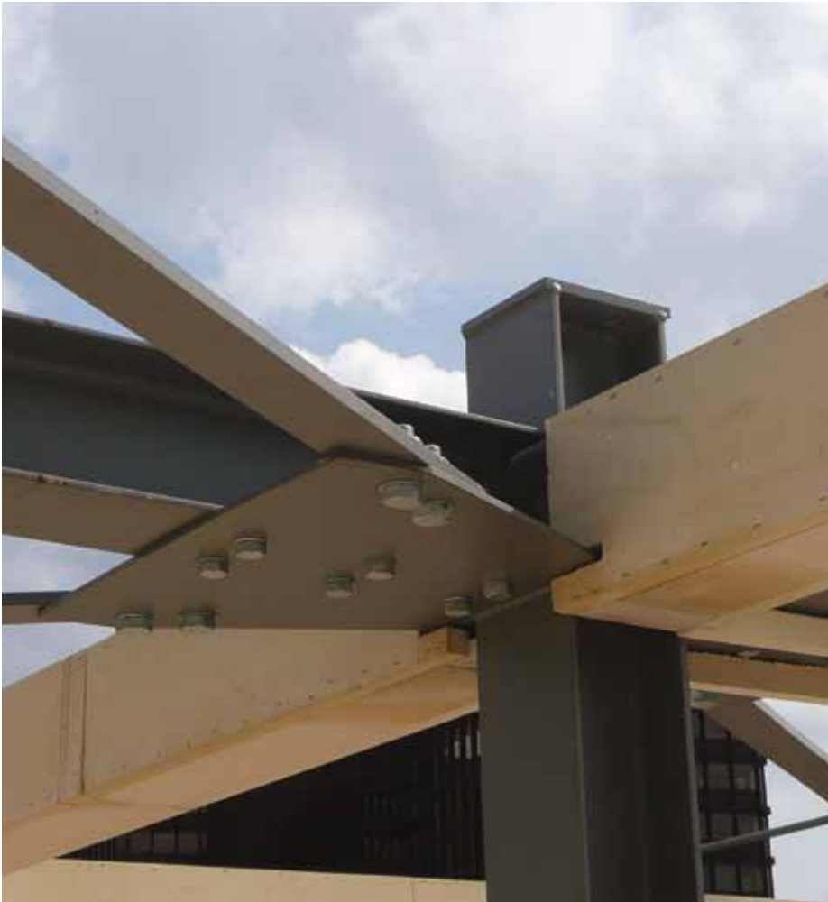
2. Aansluiting van de HEA 220-vloerligger aan een centrale kolom met de kran.
