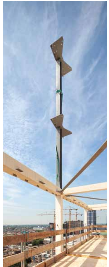
De constructie heeft een éénlaagse conservering. De profielen worden immers nog afgetimmerd.
