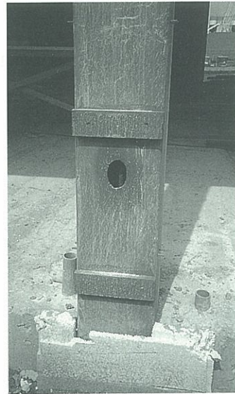
8. Kantoorgebouw Haagse Tram Maatschappij in Den Haag. Buiskolommen met wapeningkorven zijn over vier bouwlagen in één keer vanaf de begane grond met beton gevuld (foto: Voorbij Betonbouw, Wilnis).
